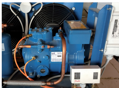
Fig.2: Rack di compressori / condensatori
