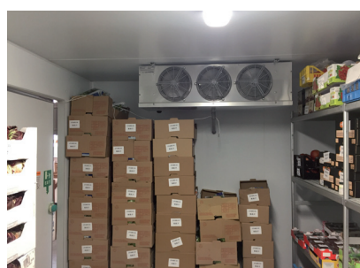
Fig.3: Evaporatori / interno celle frigorifere
