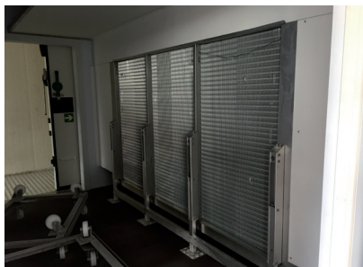
Fig.3: Interno della cella frigorifera / Evaporatore
